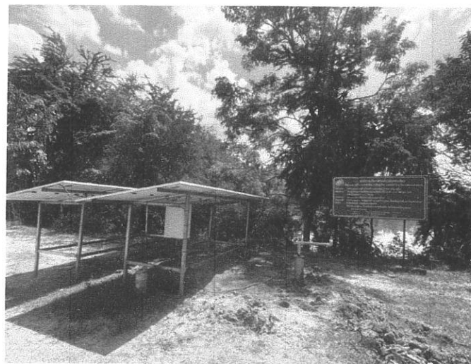
ระบบสูบน้ำโดยใช้พลังงานแสงอาทิตย์
