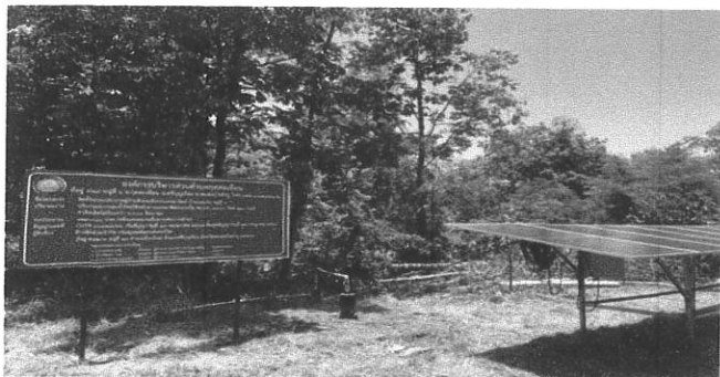
ระบบสูบน้ำโดยใช้พลังงานแสงอาทิตย์
